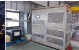
直流給電システム
